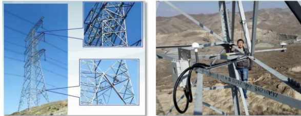
北斗变形监测装置在电力铁塔上的应用
